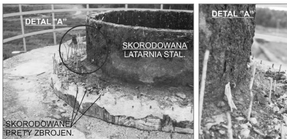
Rys. 2. Strefa kotwienia dzwonu wentylacyjnego – stadium po wybuchu biogazu
