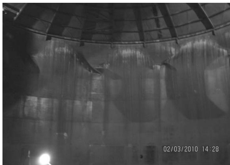
Rys. 9. Deformacje górnej części płaszcza zbiornika spowodowane wytworzonym w nim podciśnieniem
