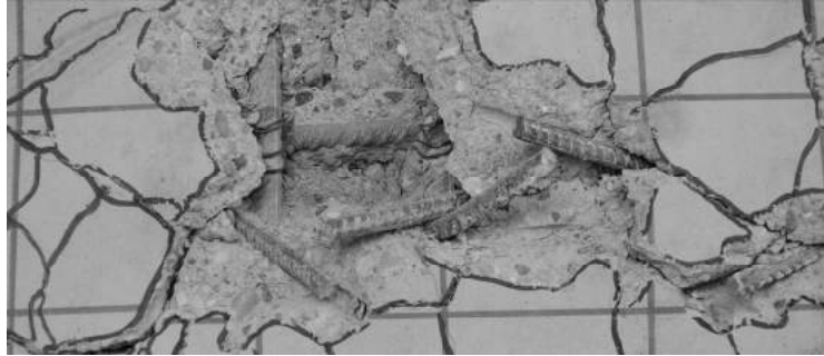
Rys. 6. Odspojenie otuliny na skutek prostowania haków strzemion, powierzchnia rozciągana modelu L-5
