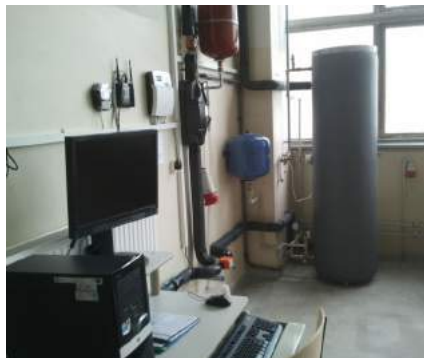
Stanowisko zdalnej kontroli instalacji
