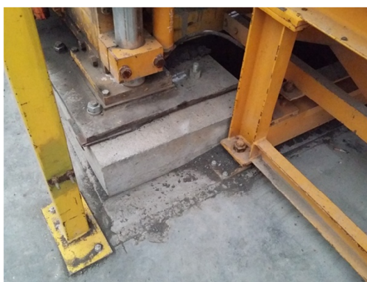
Fot. 3. Połączenie fundamentu blokowego z posadzką bez dylatacji (fot. Ł. Mrozik)
