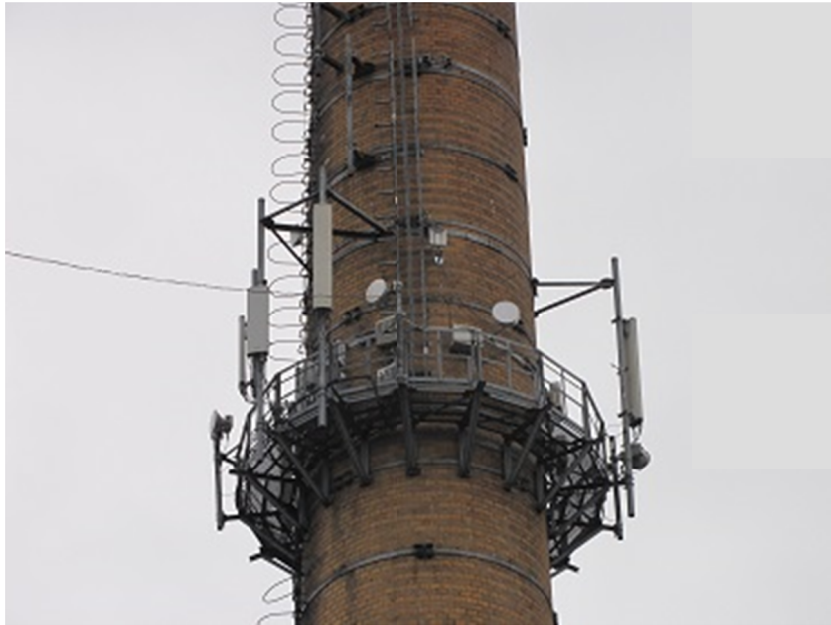
Rys. 2. Maszty antenowe zamontowane na kominie w Nowej Soli (fot. A. Kucharczyk)
