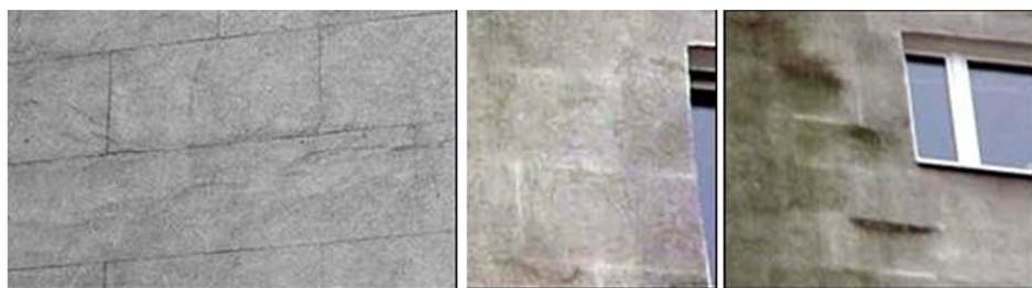
Rys. 18. Widok siatki rys wzdłuż styków pomiędzy płytami styropianowymi pod pocienioną warstwą klejowo-tynkarską
