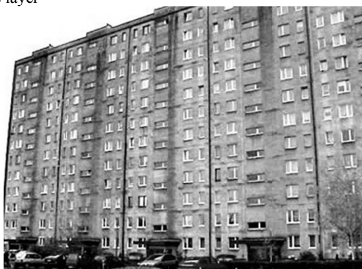
Rys. 19. Widok zacieków i korozji biologicznej na powierzchni ocieplonej elewacji po 7-letniej eksploatacji
