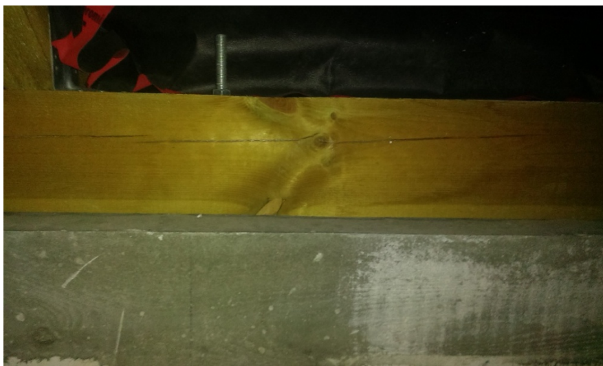
Rys. 3. Spękania drewna powstałe podczas wysychania elementu [opracowanie własne]
