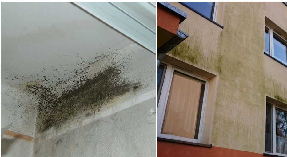
Rys. 2. Przykłady korozji biologicznej i chemicznej [opracowanie własne]
