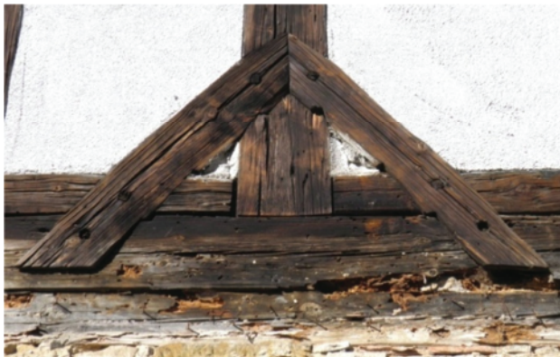
Rys. 6. Spękane podłużnie oraz skorodowane drewniane elementy konstrukcji ściany
