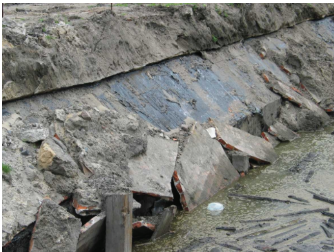
Rys. 5. Widok uszkodzeń izolacji i ścianki dociskowej. Zalanie wykopu wodą napływającą ze studni artestyjskiej
