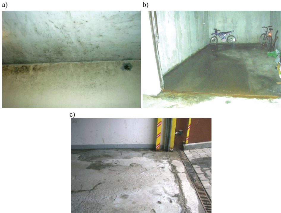
Rys. 3. Przykłady uszkodzeń wewnątrz budynków:
