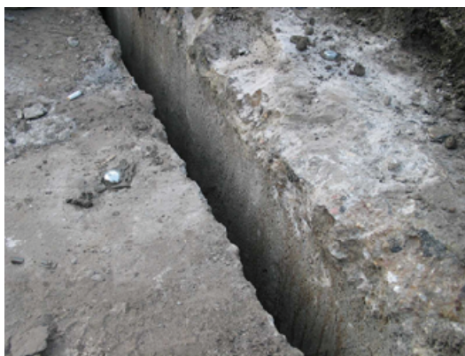
Rys. 9. Szczelina powstała na styku ściany zewnętrznej i płyty stropowej schronu
