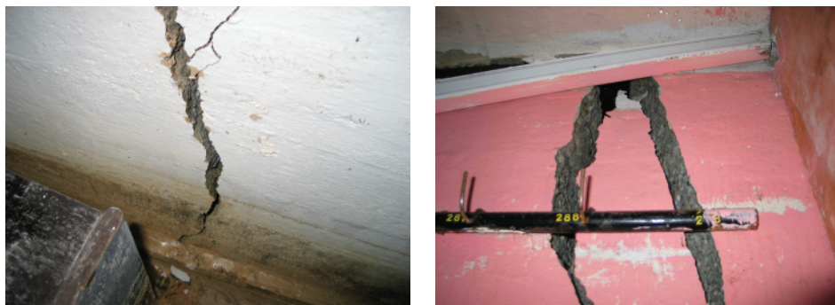
Rys. 8. Pęknięcie zewnętrznej ściany poprzecznej schronu
