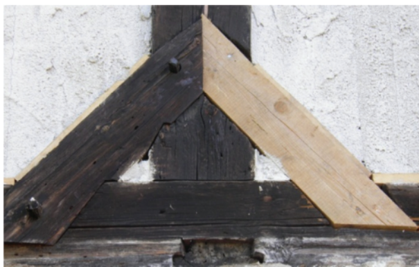
Rys. 7. Niewłaściwie wykonane połączenie starych i nowych elementów ściany
