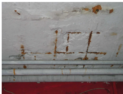
Rys. 7. Korozja zbrojenia płyty stropowej
