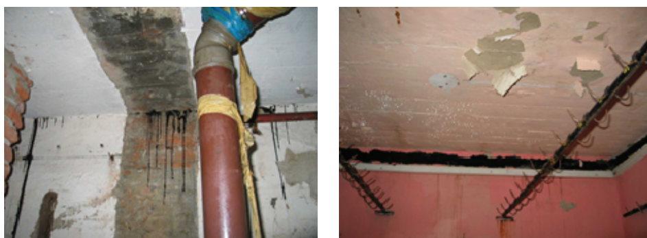
Rys. 10. Oparcie płyty stropowej na ścianie zewnętrznej od wykopu – przed i po awarii
