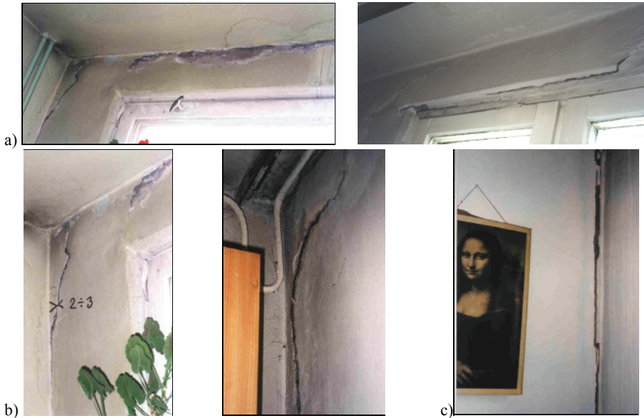
Rys. 5. Przykłady uszkodzeń wskutek zlikwidowania szczeliny dylatacyjnej pomiędzy stropem a górną krawędzią ściany ZWO: a) ścięcia górnego naroża ścian ZWO, b) towarzyszące zarysowania w złączach pionowych ZWO-W-ZWO, c) szczelina o szerokości 5-8 mm między ścianą ZWO i ścianką działową usytuowaną w połowie długości ściany ZWO [14]
