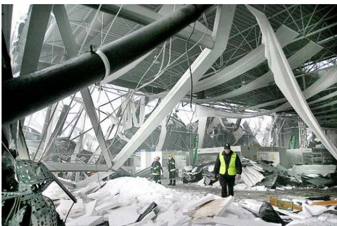
Fot. 2. Katastrofa hali wystawowej w Katowicach, widoczne elementy konstrukcji, które utraciły stateczność [fot. A. Prugar]
