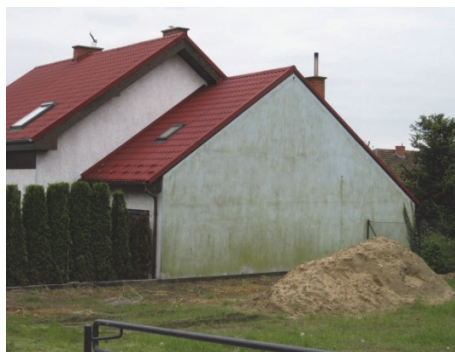
Rys. 3. Rozwój glonów na elewacji budynku przy ul. Kołątaja w Toruniu – archiwum autora
