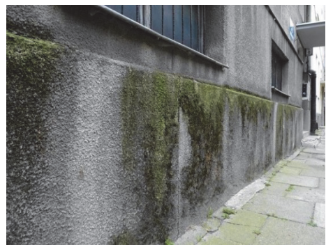
Rys. 4. Elewacja z glonami – budynek w miejscowości Lichnowy – archiwum autora
