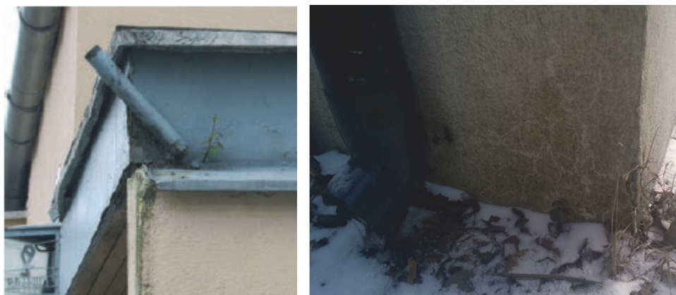
Rys. 9. Glony na ścianie północnej z widocznym zagęszczeniem przy rurze spustowej – budynek przy ul. Mohna 2 w Toruniu – archiwum autora
