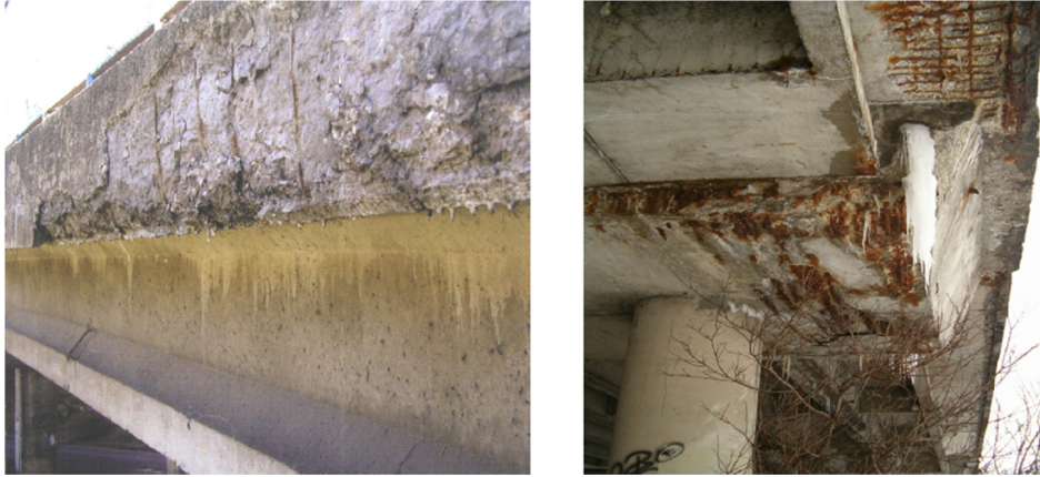
Rys. 3. Uszkodzenia obiektu mostowego w wyniku agresywnego oddziaływania środowiska [8]
