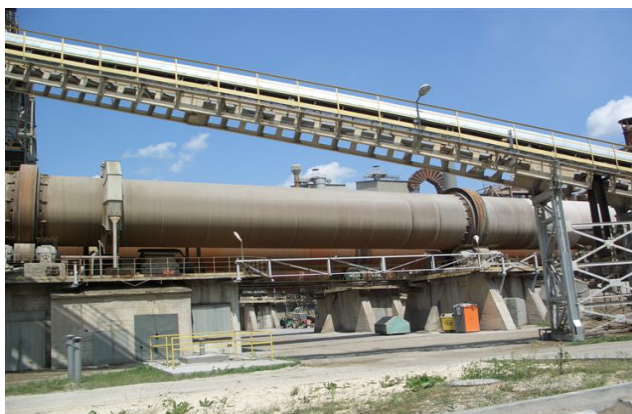
Rys. 4. Piec obrotowy do spalania osadów
